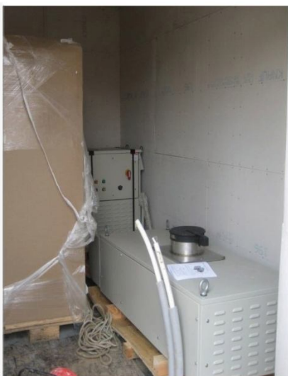
Комплект поставки для Энергоцентра: микротурбина, теплоутилизатор, дожимной газовый компрессор
