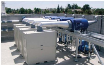
На коттедж. пос.: когенерационный кластер из МТ 65 кВт
