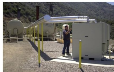
Работа МТ 65 кВт обеспечена привозным сжиженным газом
