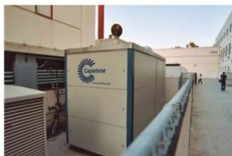
На офисно-складском центре: МТ 200 кВт
